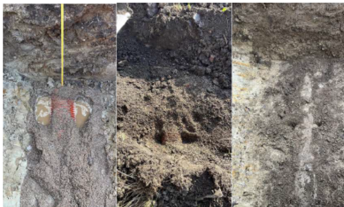
Billeder 1-3: Billeder af eksisterende forhold ved frigravning. Dele af det oprindelige Ø250 beton, er erstattet af Ø315 plast, desværre anlagt med bagfald.
